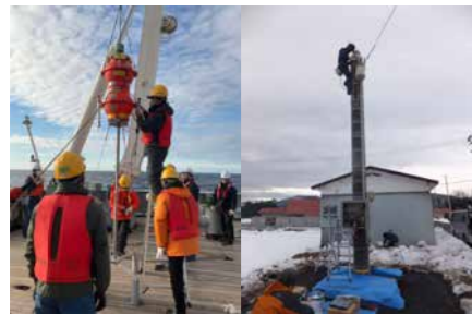
▲左の写真は、日本海溝軸に海底間音響測距装置(中央オレンジ色の機材)を設置している様子。設置はウィンチを使用し、海面下3000mまで繰り出し、予定地点に正確に設置した。右の写真は、地殻変動連続観測のためのGNSS観測装置の設置作業。コンクリート柱上にGNSSアンテナを設置している様子。
