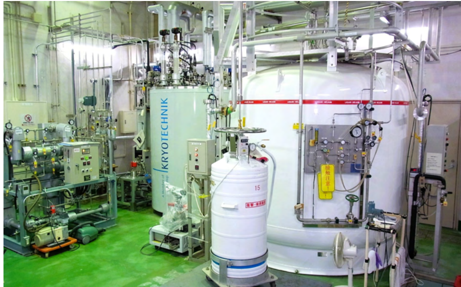
▲液体ヘリウムの供給を担うヘリウム液化設備
