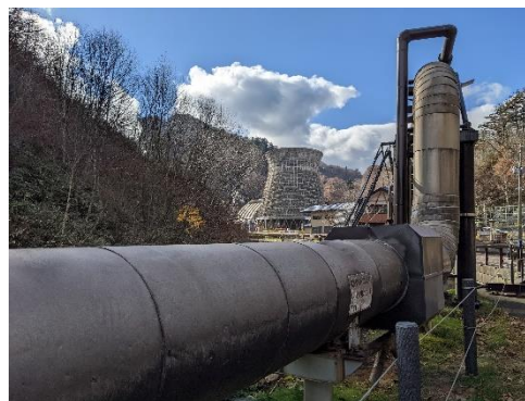
図 2 地学関連施設見学(八幡平松川地熱発電所)
