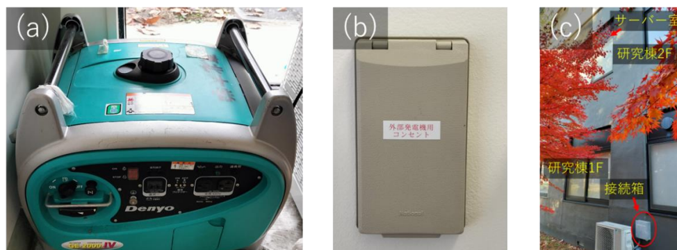
図 1 (a)デンヨー製インバーター発電機(出力 2kVA)、(b)サーバー室内に設けられた発電機用コンセント、(c)発電機はエアコン屋外機の近傍に設置し、発電機の出力ケーブルは接続箱内の端子台に接続する。
