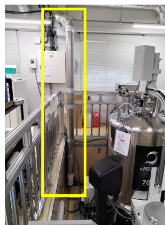
図6 ピット内換気ダクト
