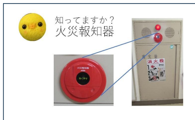
図2 火災報知器のボタン
