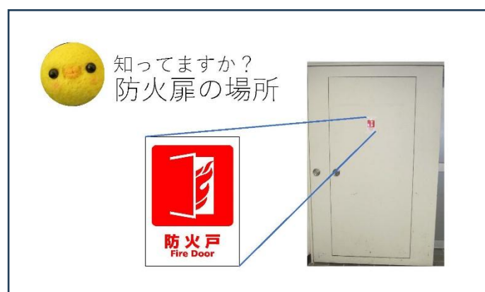
図3 防火扉の掲示
